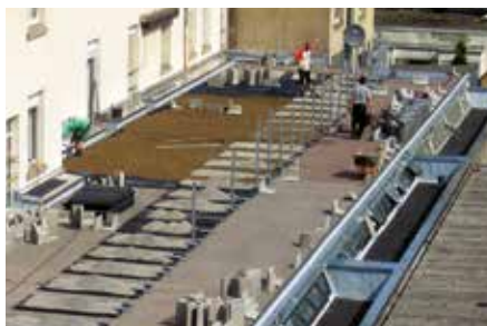
Stabilisation des éléments avec lestage de gravillons. Ce lestage sert également de lit pour la pose ultérieure de dallettes.
