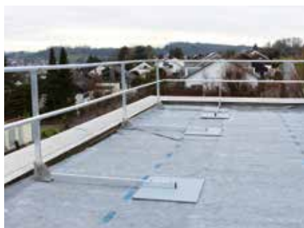
L'illustration montre les modules de poteaux avant la pose de la structure du système de végétalisation.
