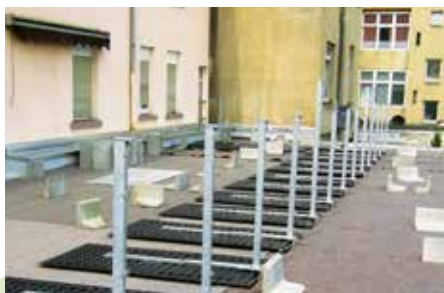
Après la pose d'une couche de protection sur l'étanchéité, mise en place des bases de balustrade GB/GB angle et montage des poteaux et des supports pour le rail d'ancrage.
