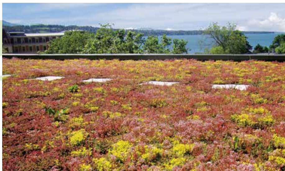
Végétalisation extensive de toiture
